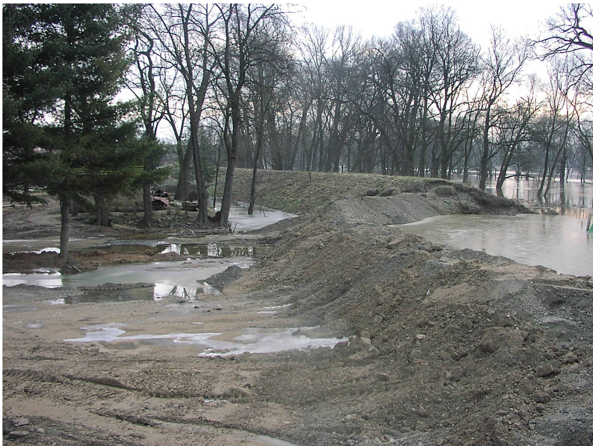
5) Nově nasypaná ochranná hráz u obce Vrbno
